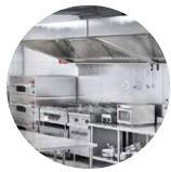
中央厨房设备
